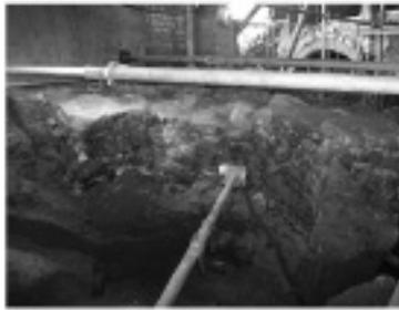
煙突内面 (煤で黒くなっている)
