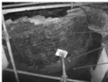
破断面 煙突外面 雨除けカバーの取り付け金具か？（鉄製） 煙突先端部
