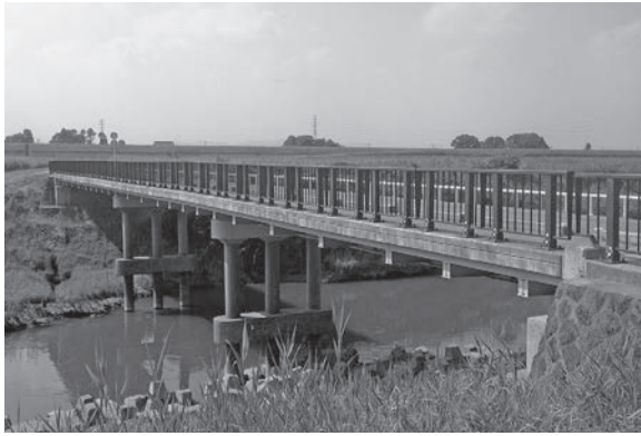
国と修繕工事の協議を進めている友沼橋
