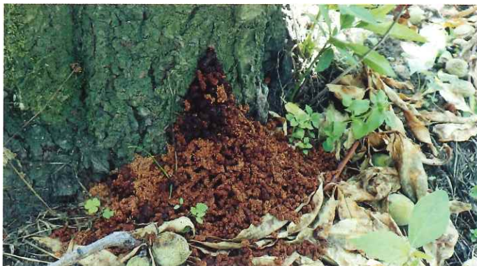
幼虫の食害により排出された大量のフラス
