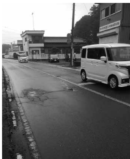
舗装の修繕を待つ道路
