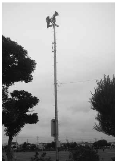
町内に39基設置予定の防災行政無線
