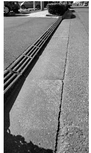
段差がきつい歩道
