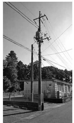
無電柱化が望まれる電柱
