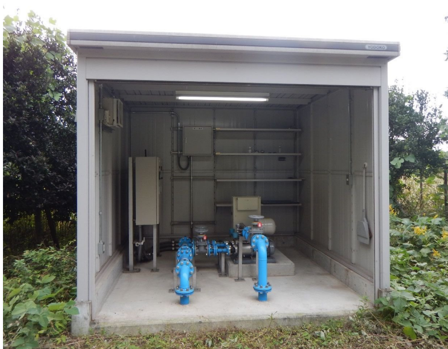
川田地区増圧ポンプ場（野木町大字川田）
