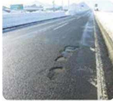
路面の穴ぼこ・ 段差
