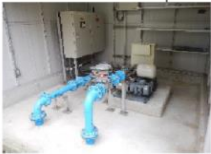
川田地区 増圧ポンプ場
