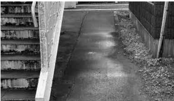
冠水対策要望箇所
